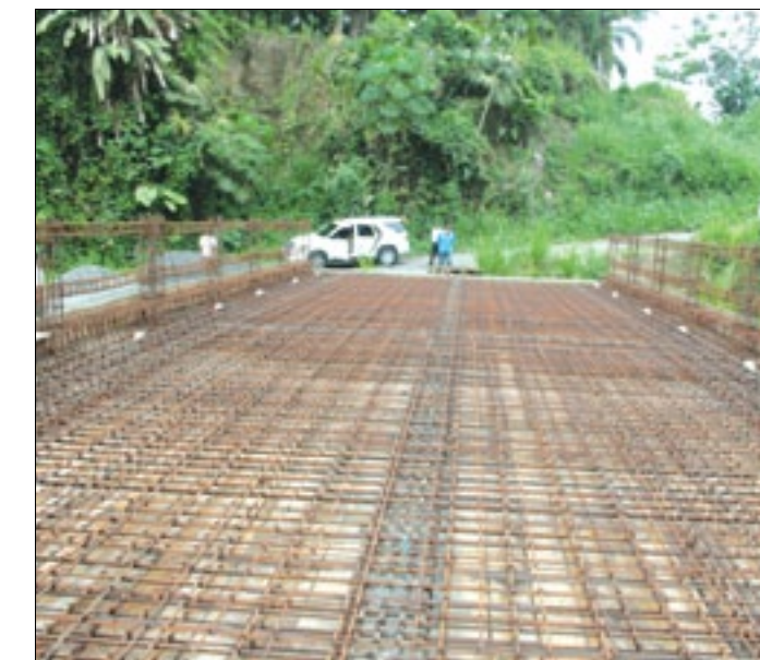
Los beneficiarios se encuentran a la espera que los puentes se los termine antes de la temporada invernal
